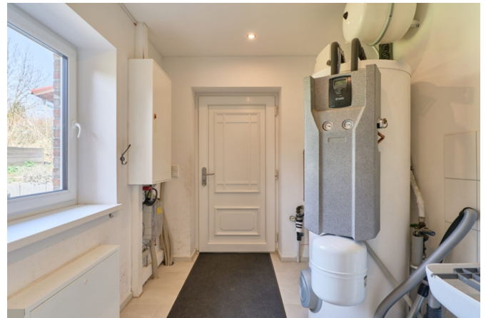
Hauswirtschaftsraum mit Heizung und Außentür
