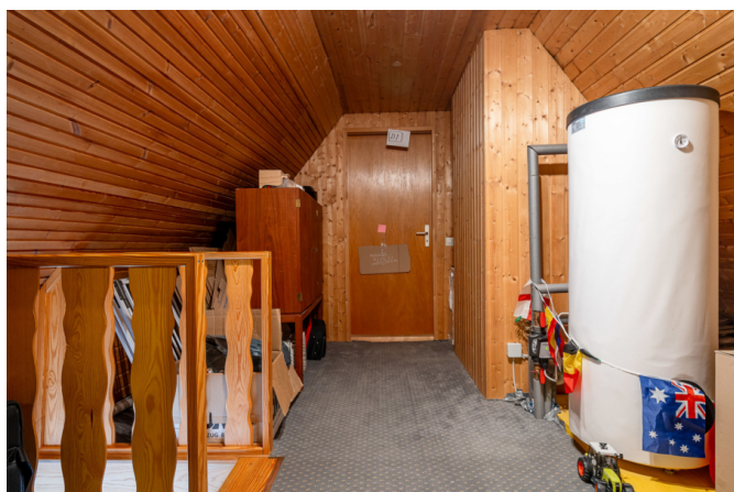
Wohneinheit Nr. 1 - Spitzboden mit Warmwasserspeicher
