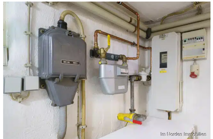
Hausanschlüsse im Kellergeschoss
