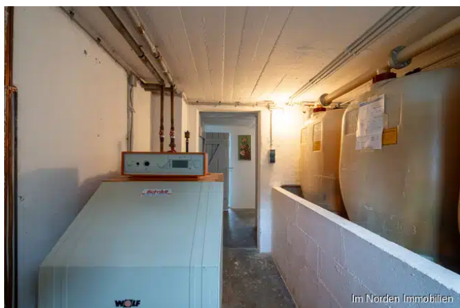
Heizungsanlage im Kellergeschoss
