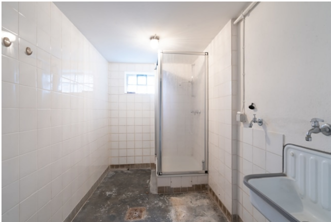
Dusche im Keller
