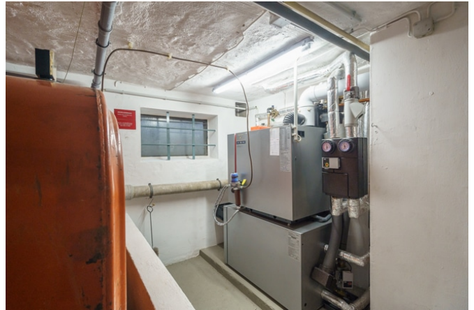
Blick auf die Heizungsanlage
