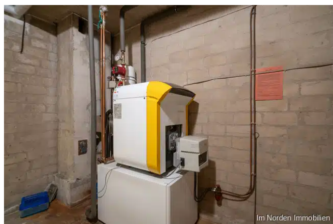
Heizungsraum im Kellergeschoss
