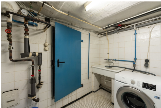
Waschküche im Keller
