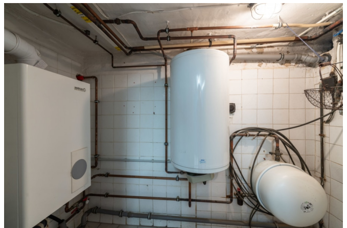
Gasheizungsanlage im Keller
