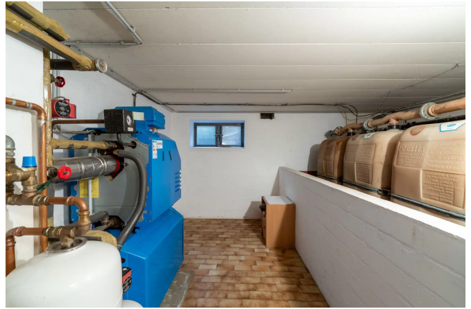
Blick auf die Heizungsanlage
