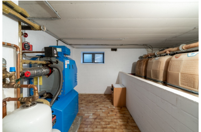
Blick auf die Heizungsanlage
