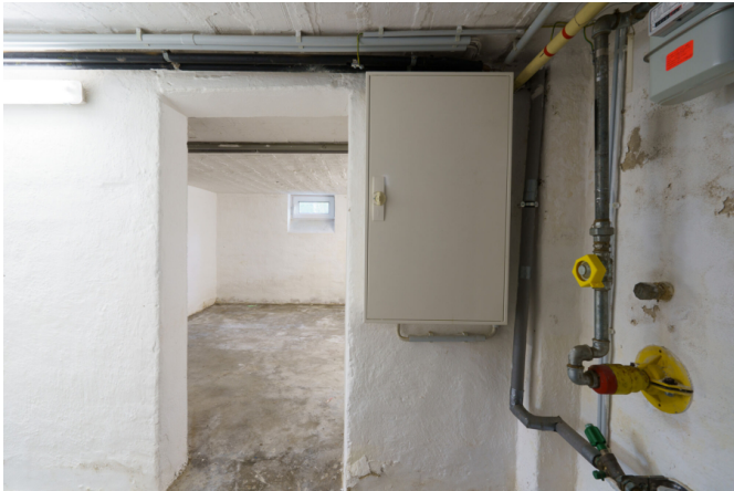
Elektrik im Keller
