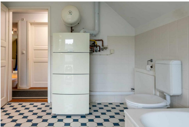
Dachgeschoss, Gasheizung im Bad
