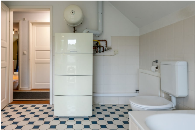
Dachgeschoss, Gasheizung im Bad
