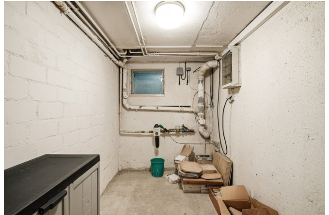
Kellerraum mit Anschlüssen
