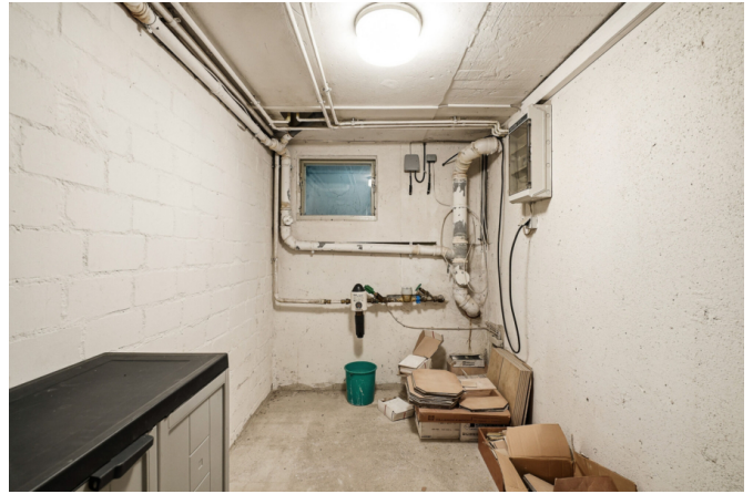
Kellerraum mit Anschlüssen
