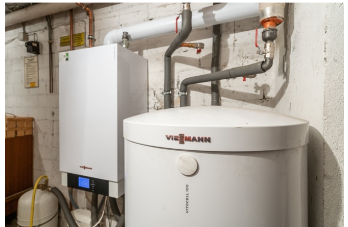
Heizungsanlage im Kellergeschoss
