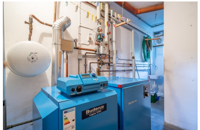
Heizungsraum im Kellergeschoss
