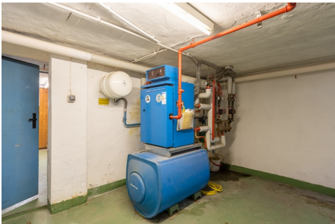
Heizung im Kellergeschoss
