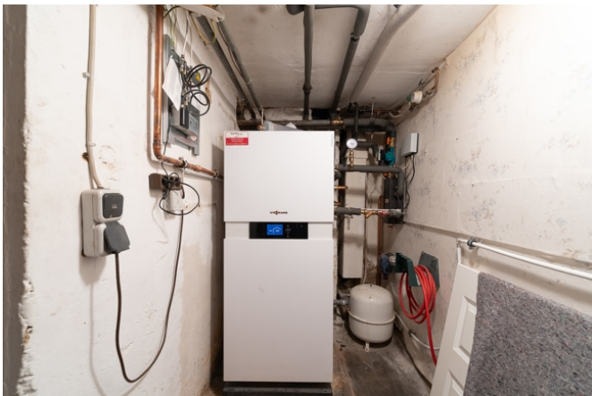
Blick auf die Gasheizung BJ. 2018
