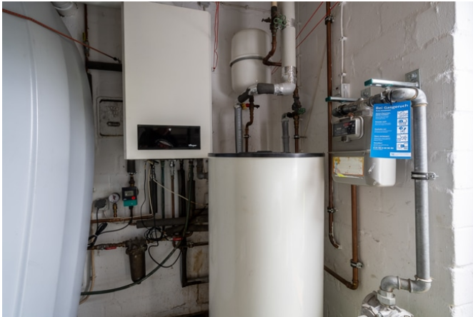
Gasheizungsanlage im Heizungsraum
