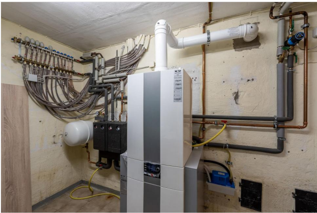
Blick auf die Gasheizungsanlage von 2020 im K
