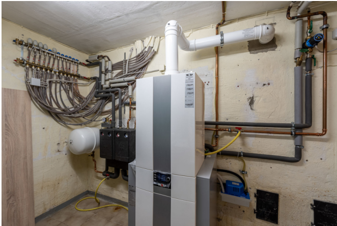
Blick auf die Gasheizungsanlage von 2020 im Kellergeschoss
