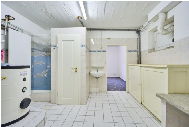
Heizung, Dusche/WC, Blick Richtung Keller 4
