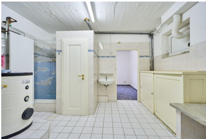
Heizung, Dusche/WC, Blick Richtung Keller 4
