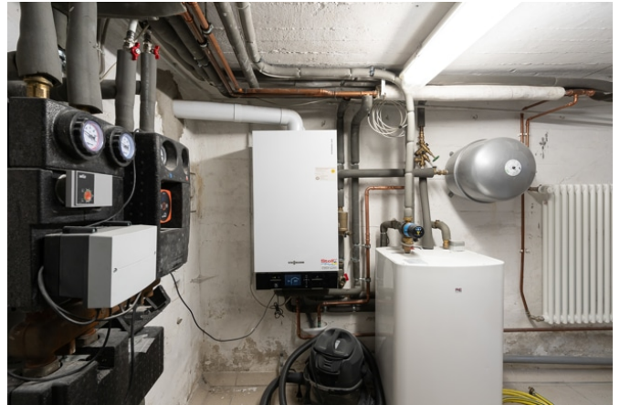
Heizungsanlage im Teilkeller
