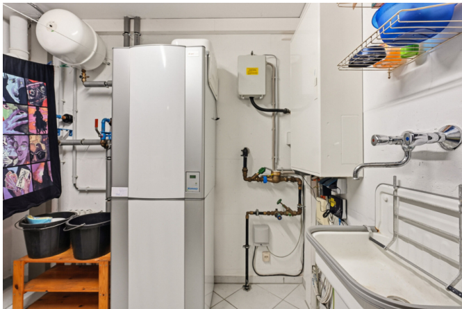
Hauswirtschaftsraum mit Heizung
