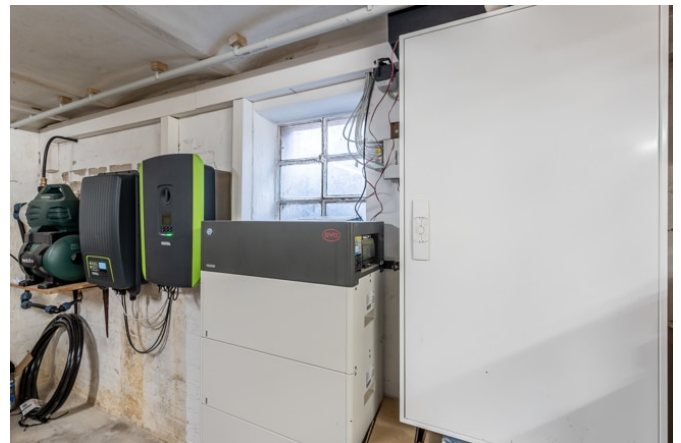
PV-Technik und Hauswasserwerk im Kellergeschoss
