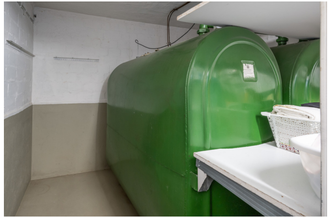
Tank für die Öl-Heizungsanlage im Kellergeschoss
