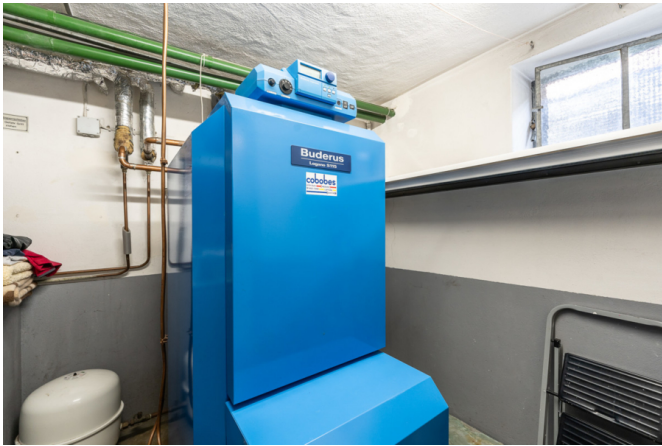
Öl-Heizungsanlage von 2003 im Kellergeschoss
