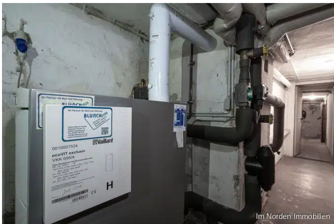
Kellerbereich und Heizung im Vorderhaus
