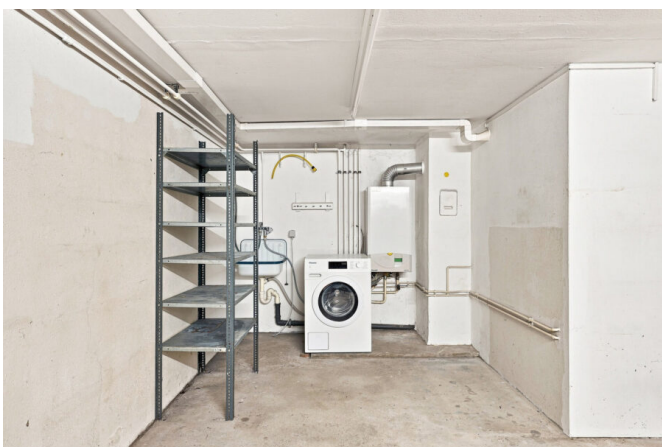
Heizungsbereich im Keller im Keller
