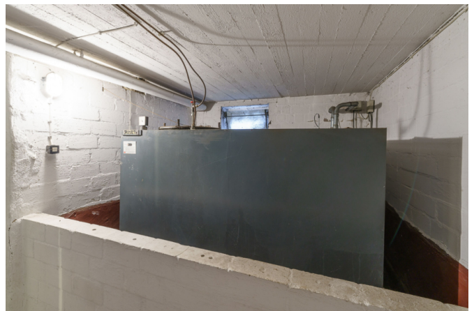
Öltank im Kellergeschoss
