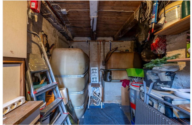
Öltank Lagerraum im Hogbeäude
