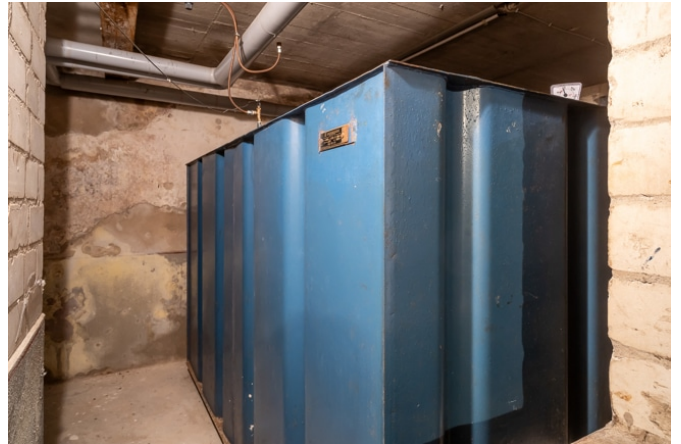
Öltank im Kellergeschoss
