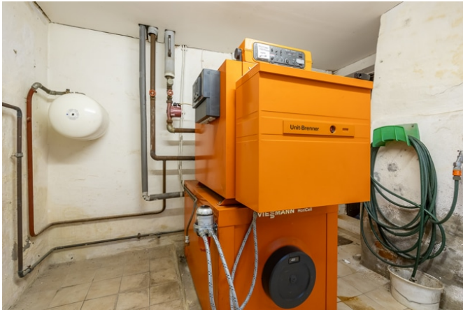
Heizungsanlage im Kellergeschoss
