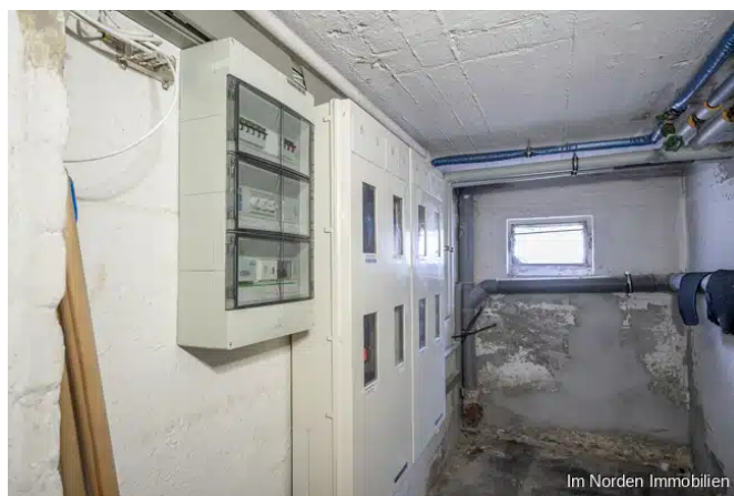
Stromzähler im Kellergeschoss
