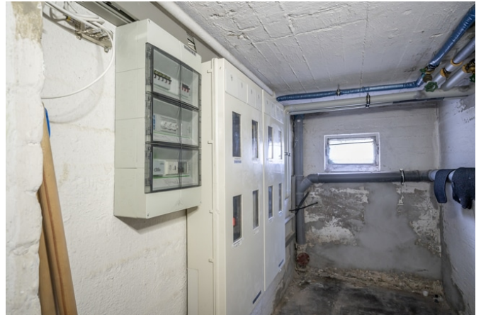
Stromzähler im Kellergeschoss
